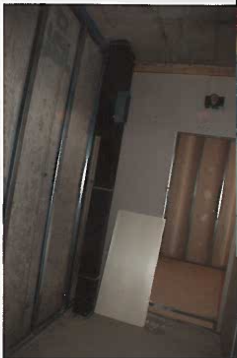
Impianto di ventilazione
