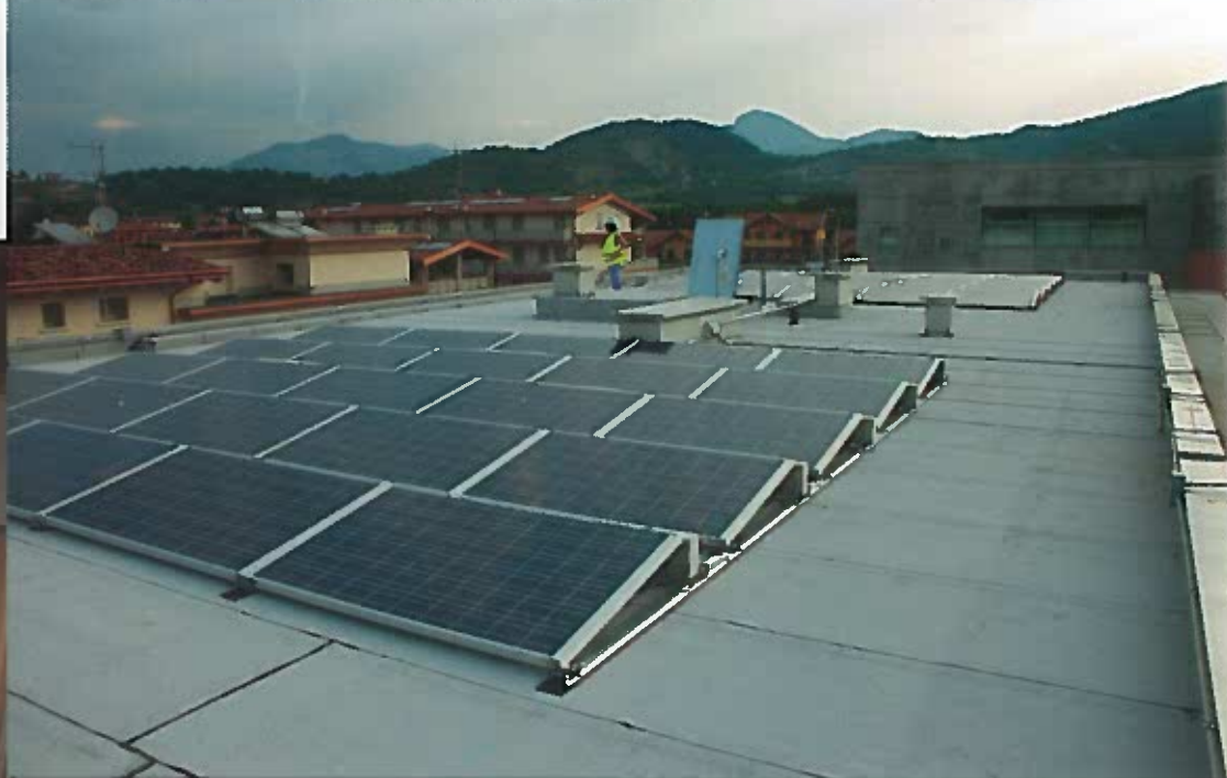
Pannelli solari in copertura
